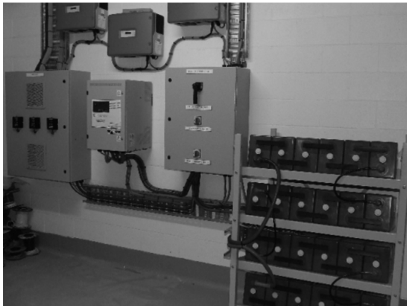
FIGURA 1.5. Sala amb bateries estanques de plom àcid
