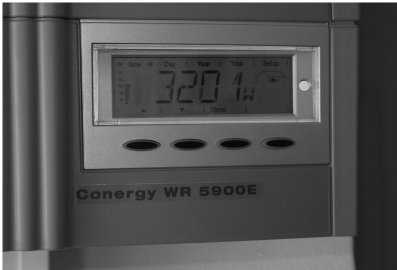
FIGURA 1.11. Panell informatiu d'un convertidor de connexió a la xarxa
