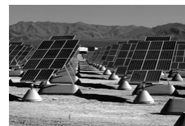
Central elèctrica fotovoltaica, que transforma directament la radiació solar en electricitat.
