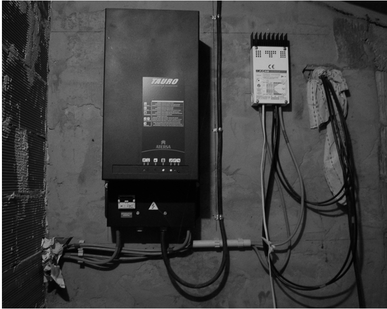
FIGURA 1.6. Instal·lació precària d'un convertidor i l'equip regulador de carregacàrrega
