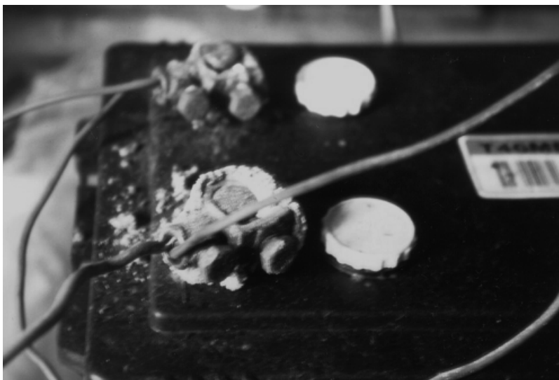
FIGURA 1.13. Bateria amb els terminals oxidats
