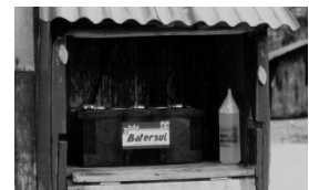
Bateria d'una instal·lació solar amb una ubicació inadequada
