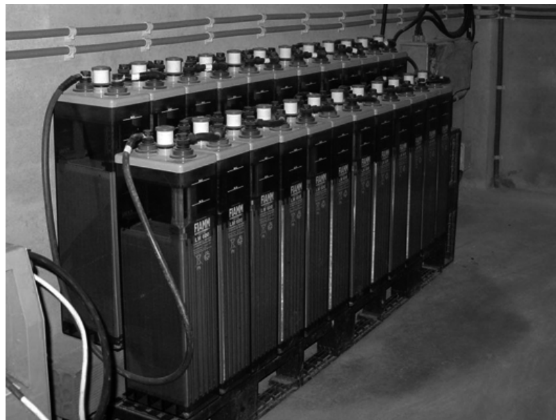
FIGURA 2.9. Bateria estacionària de gran capacitat per a una instal·lació solar
