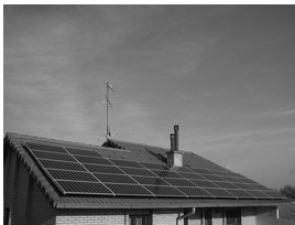
Instal·lació solar fotovoltaïca autònoma
