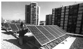
Plaques fotovoltaïques, ancorades sobre lloses de formigó sobreposades a la coberta
