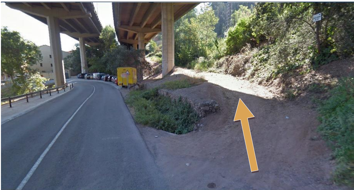
Il·lustració 10 Vista des de sota de l'AP-7 del primer accés. Font: https://www.google.com/maps/views/streetview?gl=es&hl=es
