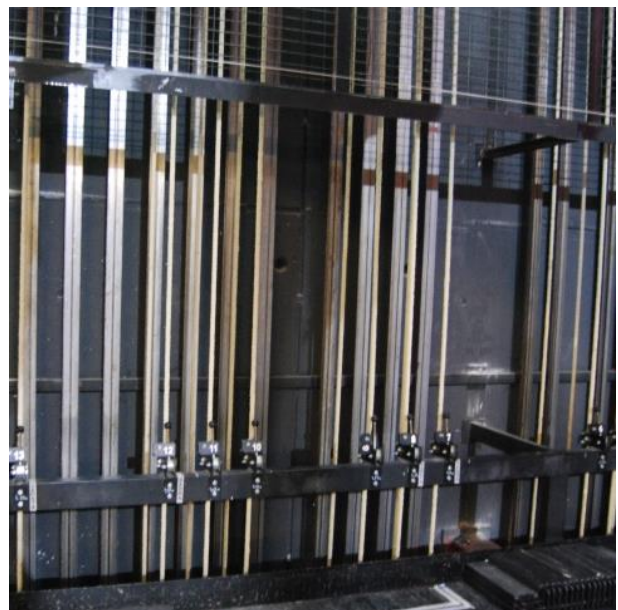
Sistema de contrapesos del Teatre Atrium de Viladecans
