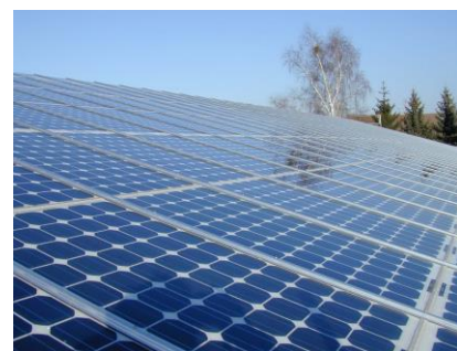
Figura 33: Conjunt de plaques fotovoltaïques
