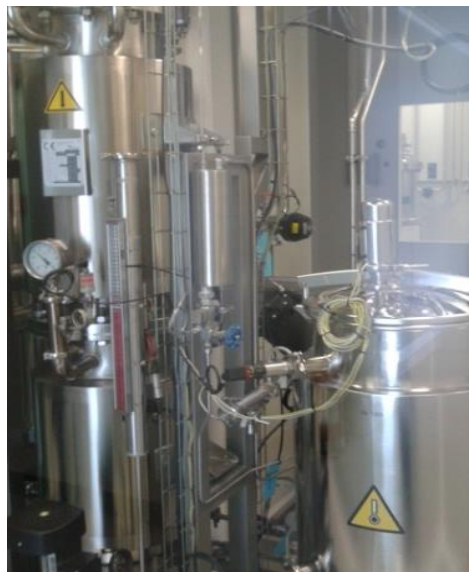
Generador i instal·lació WFI. Font d'elaboració pròpia.
