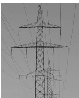
Línia d'alta tensió
