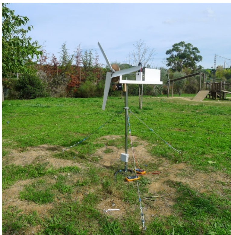
Figura 49: Aerogenerador amb els dos multimetres connectats
